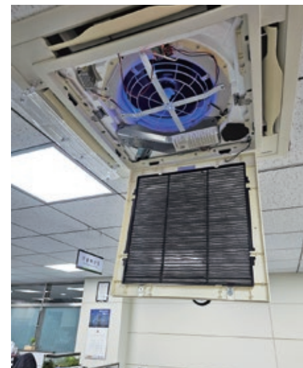
라파비 UV 크로스파워 공기살균기가 설치된 모습
